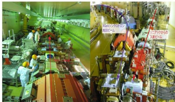
J-PARC加速器 3 GeVシンクロトロン入射部 写真提供：J-PARC
